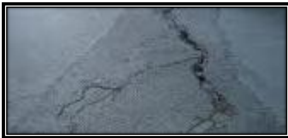
Fig. 2.13 Grieta errática o en zigzag
