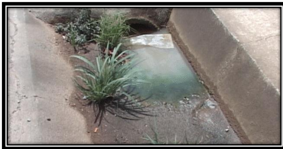
Fig. 2.22 Azolve en drenaje superficial
