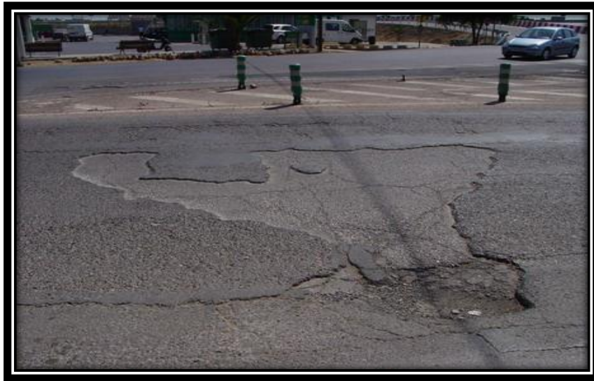
Fig. 2.5 Desprendimiento de sello
