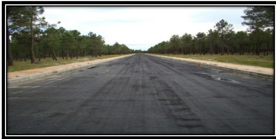
Fig. 2.19 Llorado de asfalto
