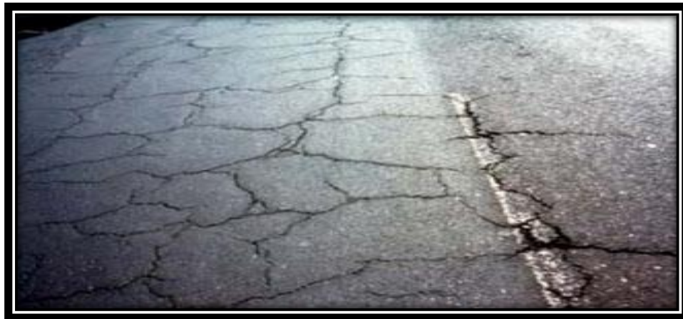
Fig. 2.10 Grietas de reflexión
