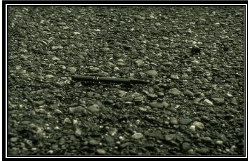
Fig. 2.3 Desprendimiento de agregados
