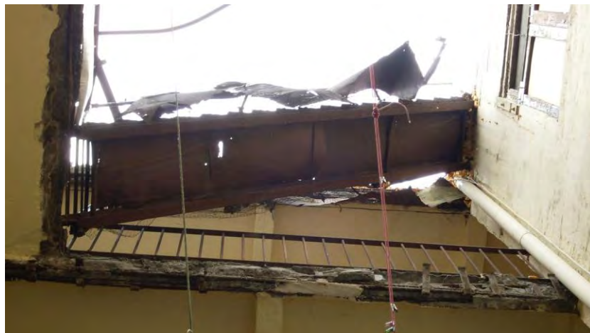
Fig. 47. Daños en entrepisos que permiten observar el armado con varillas de acero, (2010).
