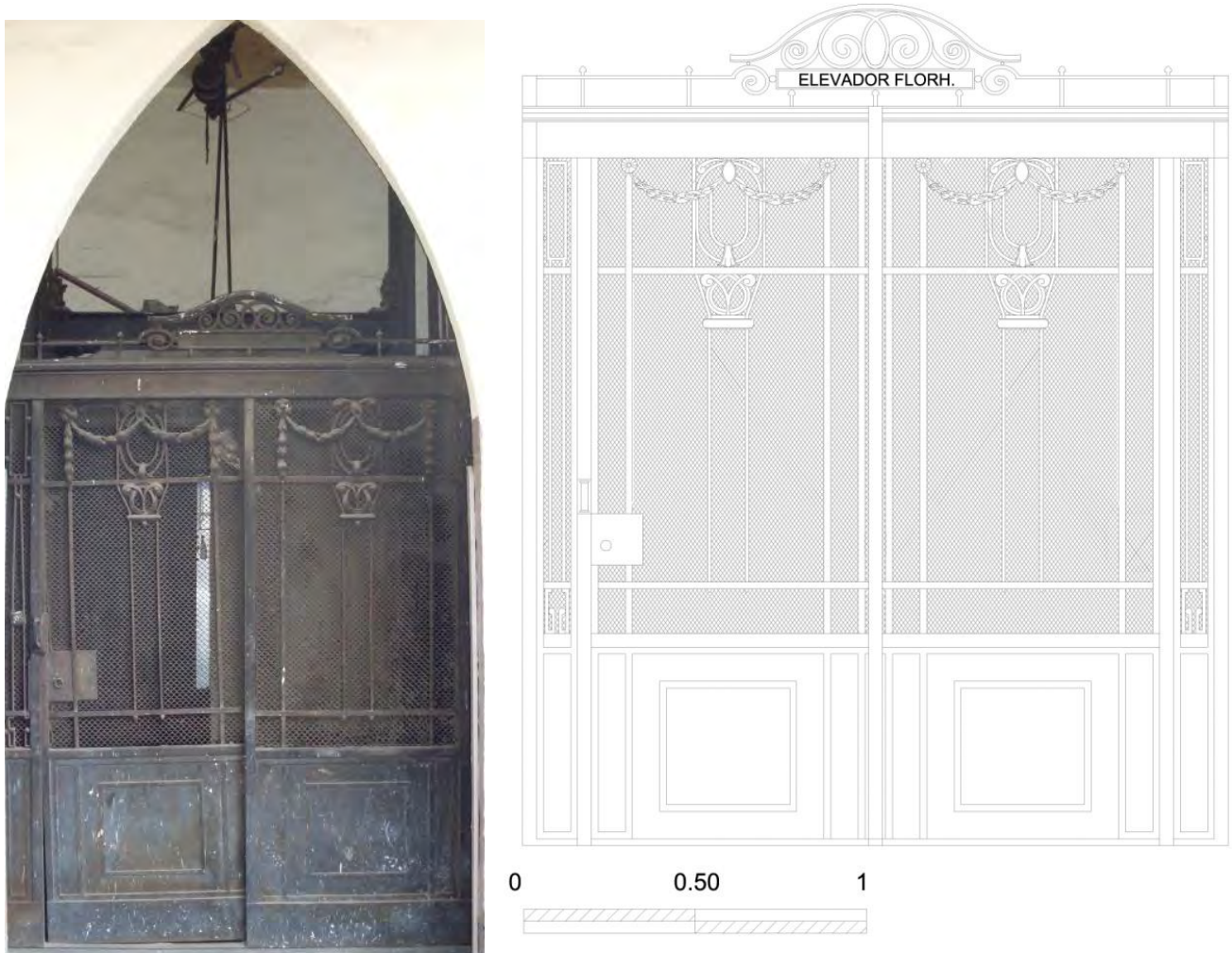
Fig. 108 y Fig. 109. Elevador Florh que aún se halla en la actualidad; sin funcionamiento. Véase el diseño y la ornamentación propios de un lugar en donde se hallaban elegantes despachos y oficinas.
