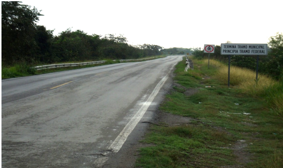
Figura 5.9. Inicio del tramo en estudio (kilómetro 32+000), se observa el estado actual del pavimento y del señalamiento.
