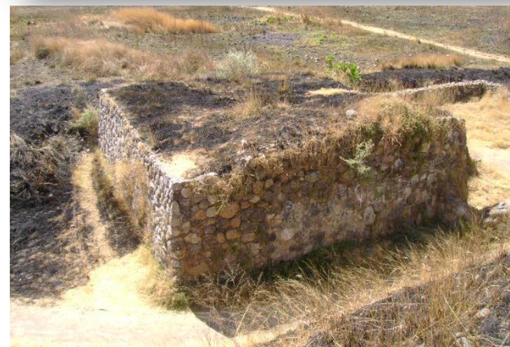
Sitio Iztépete en Zapopan Jalisco. Muestra grafiti e incendio provocado en uno de los edificios y la falta de interés y protección hacia el único museo de sitio del área metropolitana de Guadalajara. Foto: Autora. 2011.
