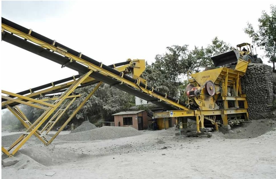
Planta de trituración y elaboración de concreto asfáltico.
