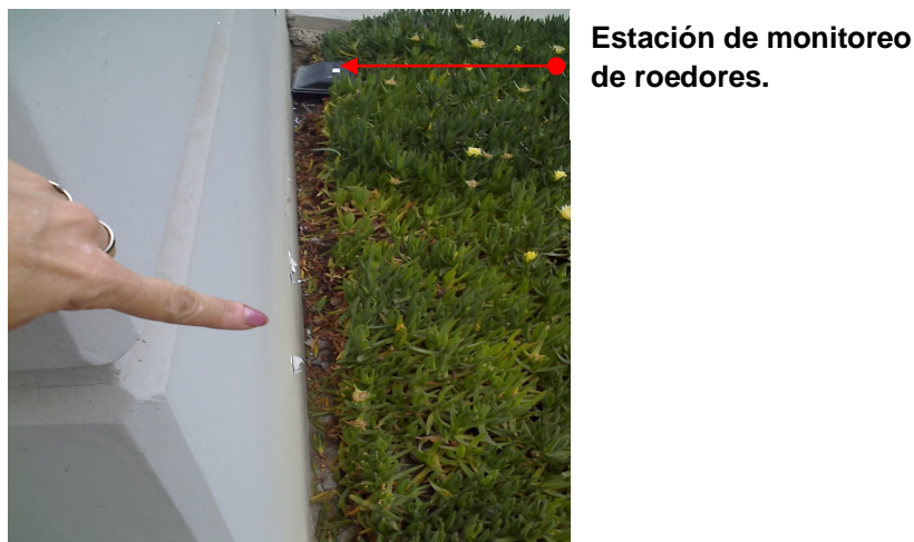
Fig. 4.2. Deshierbe y terraplén con grava y estación de monitoreo, pegado al inmueble [76].
