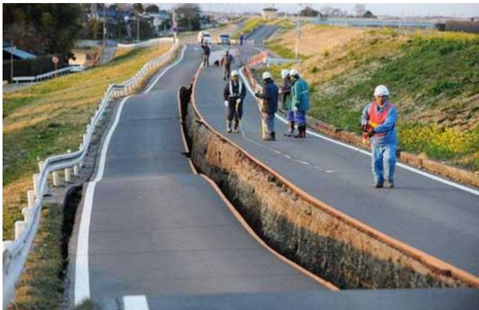
Figura 3.4 Daños a infraestructura debido a hundimientos causados por licuación.
