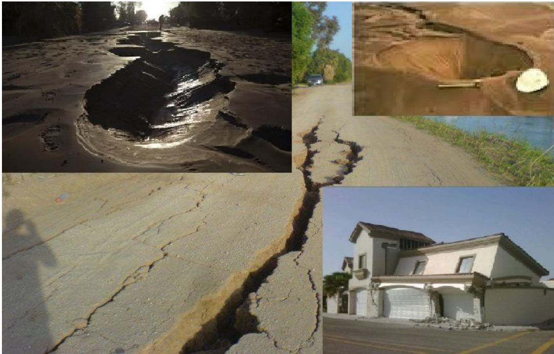
Figura 3.8 Daños provocados por el fenómeno de licuación.
