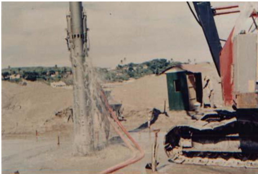
Figura 4.10 Vibrador de fondo y colocación de relleno, Alvarado, Veracruz, 1963 (cortesía Ing. Rolando Ugalde).
