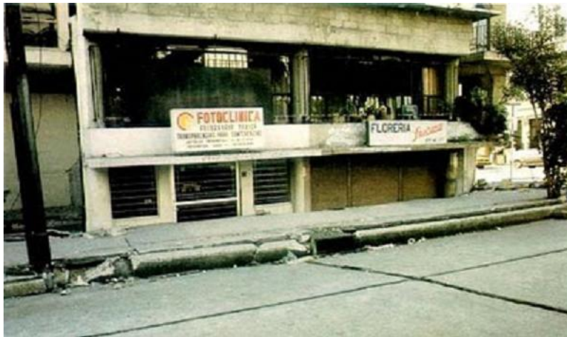
Figura 3.3 Asentamiento causado por licuación.
