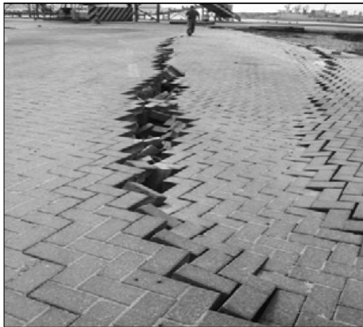
Figura 3.6 Desplazamiento lateral en pavimento en el puerto de Manzanillo. Wartman, et al. (2003) .
