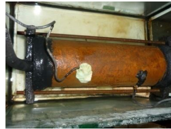
Foto 3.12 Corrosión a bajas temperaturas
