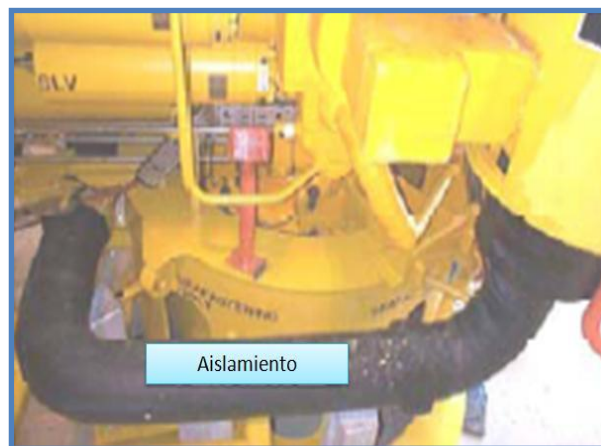
Figura 4-4 Aislamiento de una válvula.
