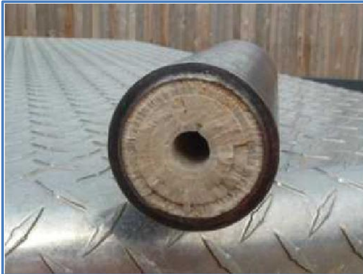
Figura 3- 13 Problemas con incrustaciones en líneas de flujo.
