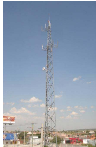
Torre de Telecomunicaciones
