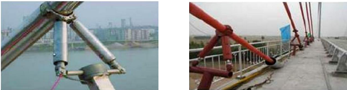
Figura 3.11 (a) Puente Lake Dongting con amortiguador MR; (b) Puente Binzhou con amortiguador MR
