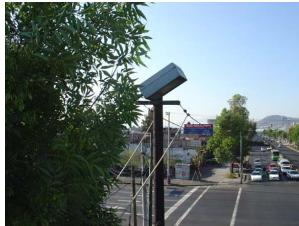
Luminaria ubicada sobre Avenida Rojo Gómez.
