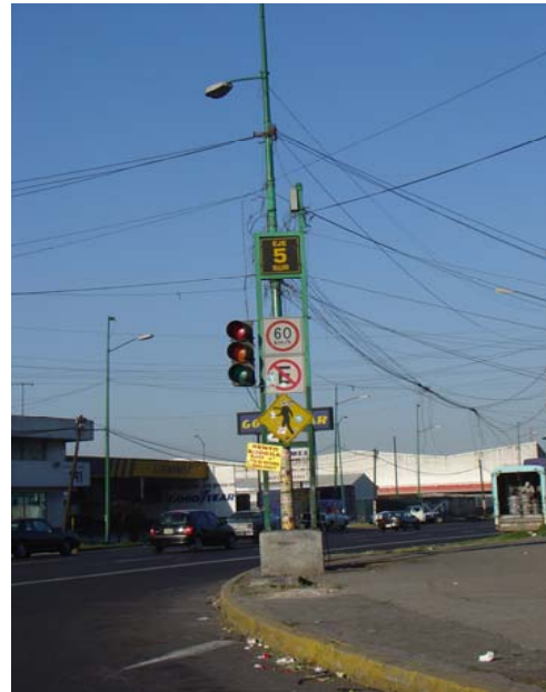
Es evidente el abuso en el robo del servicio eléctrico; ya que se presenta en cada esquina y al interior del predio
