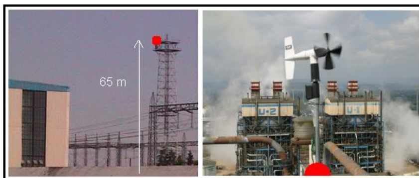
Figura 5.2 Torre de telecomunicaciones y estación meteorológica instalada a 65 m de altura sobre el nivel del suelo.
