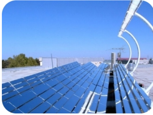
Fig. 4: Concentrador solar tipo Fresnel [33]
