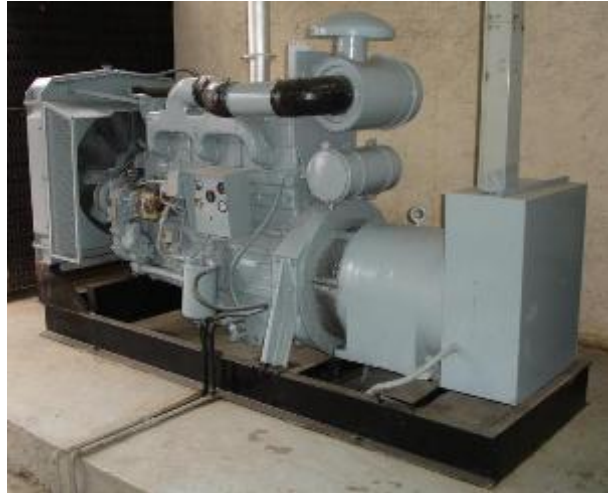
Figura 1.14 Planta de emergencia.
