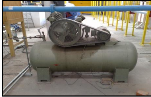
Fig.2.10 Compresor de aire.
