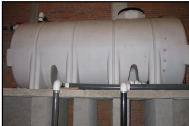
Fig.2.8 Tanque separador trifásico.
