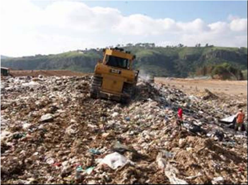
Imagen 1. Surco en hombro del talud. Relleno Sanitario de Naucalpan de Juárez, Estado de México.
