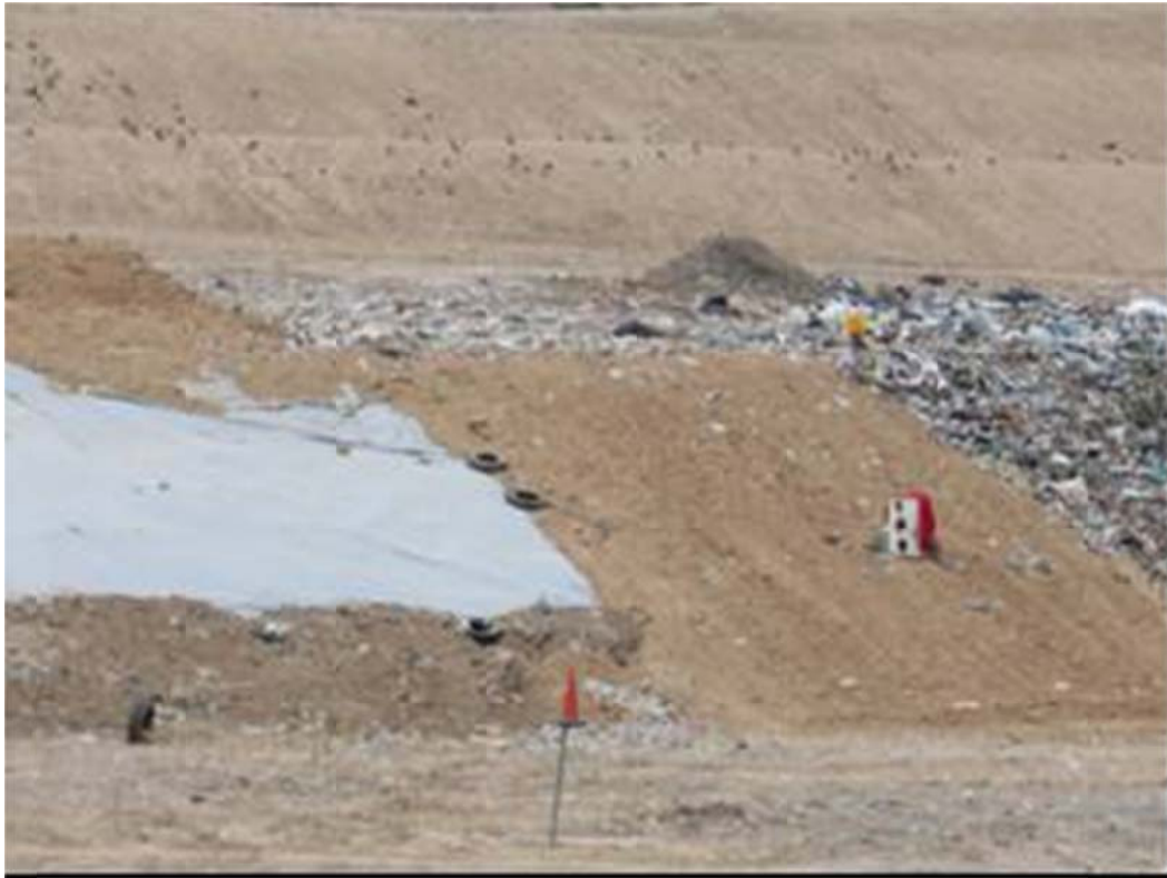
Imagen 6. Cobertura de talud con pozo de biogás. Relleno Sanitario de Naucalpan de Juárez, Estado de México.
