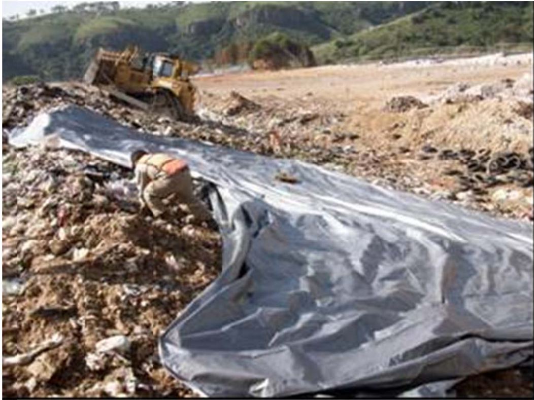
Imagen 3. Anclaje superior de lona. Relleno Sanitario de Naucalpan de Juárez, Estado de México.
