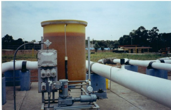
Figura 2.2. Tanque de almacenamiento del inhibidor. 10
