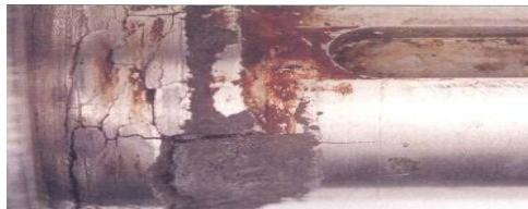
Figura 1.9. Corrosión Bajo Tensión
