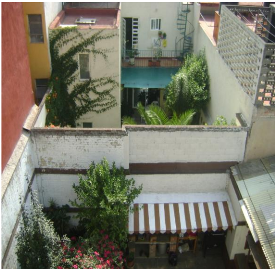
Colindancia oriente, en la cual se observa el patio y la estructura de dos niveles.
