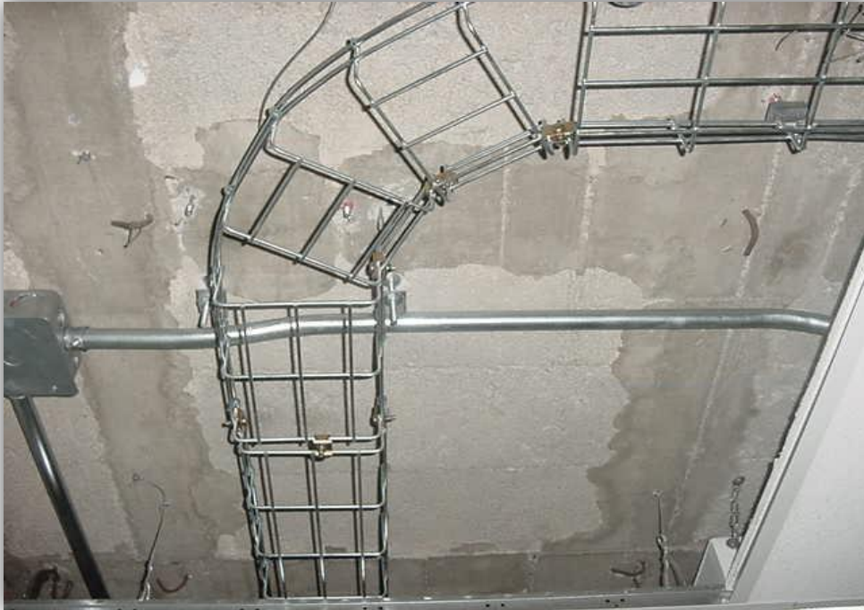
Figura 3.3.1 Canales para Cableado Estructurado.
