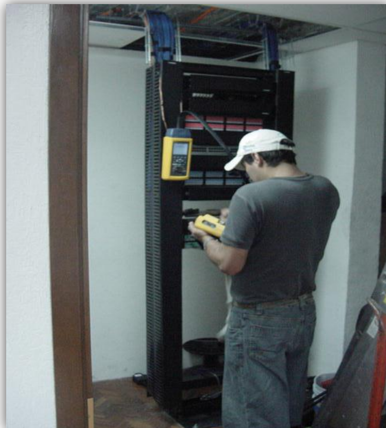
Figura 3.3.6 Ejemplo de Cuarto de Telecomunicaciones.
