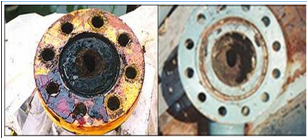
FIGURA 1.10 Obstrucción de tuberías por parafinas 17
