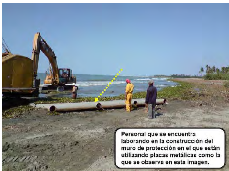
Figura B.23: Comienzo de los trabajos para levantamiento del muro a base de placas metálicas y perfiles tubulares
