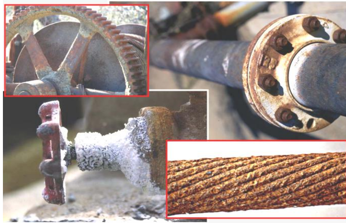
Figura 3.5 Corrosión externa en accesorios
