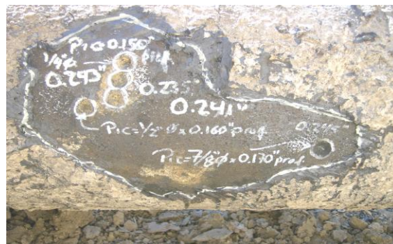
Figura 3.4 Corrosión externa en ducto
