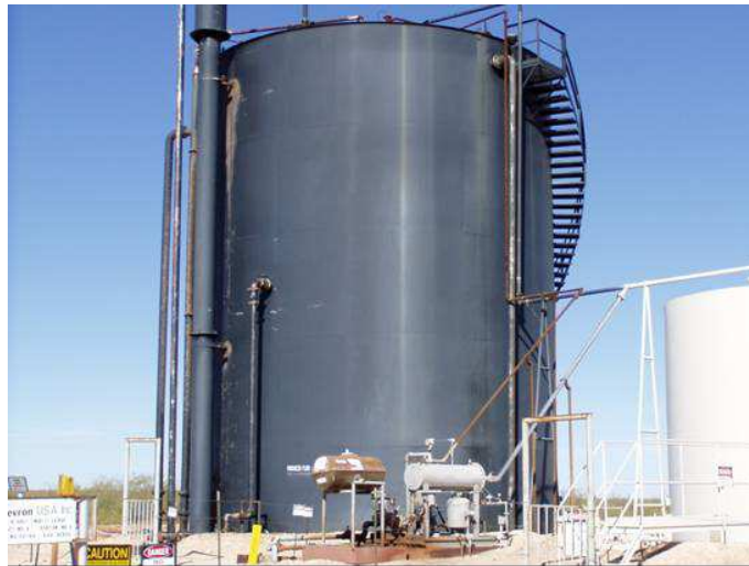
FIGURA 11. TANQUE GUNBARREL DE 5000 BARRILES DE CAPACIDAD
