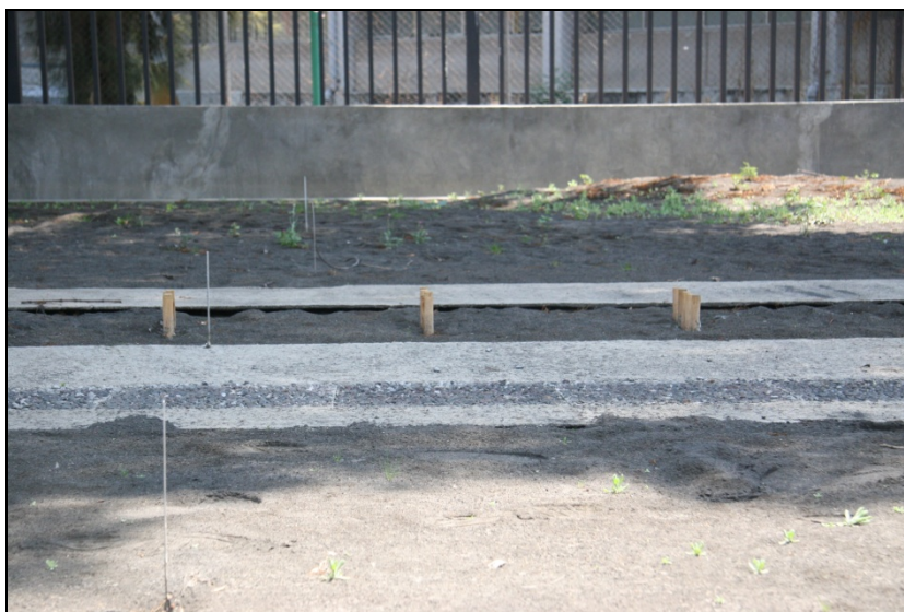
Fig. 6.2.8 Socavación de los tapetes de concreto aguas abajo de la presa tipo indio modificada
