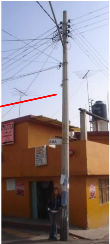
Poste con luminaria sobre calle Aldama.
