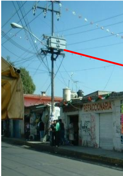
Poste con transformador en esquina de Porfirio Díaz y Allende.
