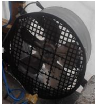
Fig.62.-Ventilador de 23 cm de diámetro.
