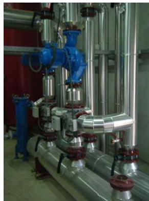
Fig.11.- Calefacción en un invernadero mediante tuberías.
