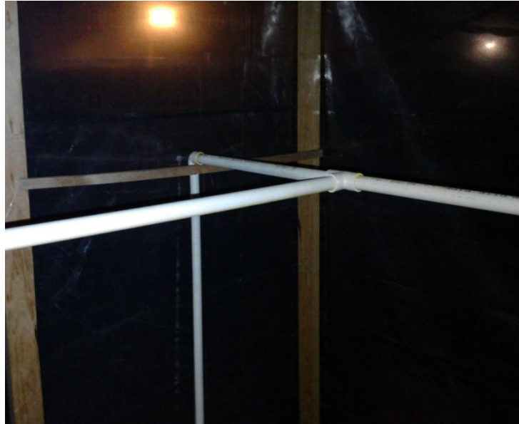
Fig.76.-Tubería de PVC para la aspersión.
