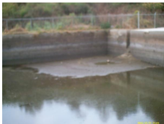
Fig.49.- Depósito para suministro de agua de riego.
