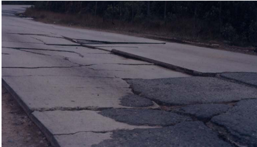
Figura 2.1 Pavimento de concreto, con secciones de bacheo de concreto asfáltico (ICPC).
