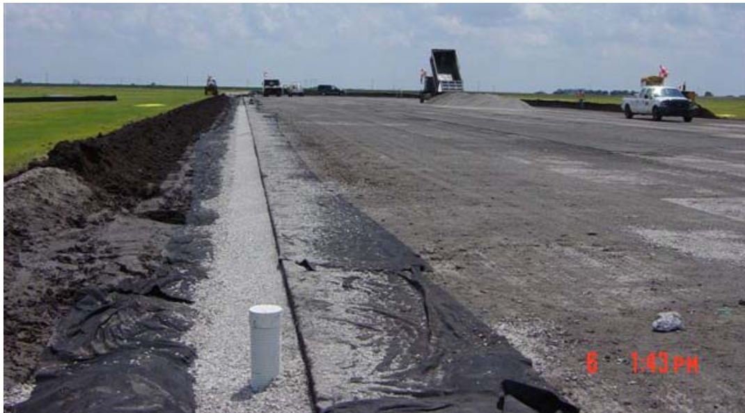
Figura 2.10 Instalación del sistema de subdrenaje en el pavimento de una aeropista previo a los trabajos de rubblizing (Asphalt Institute).
