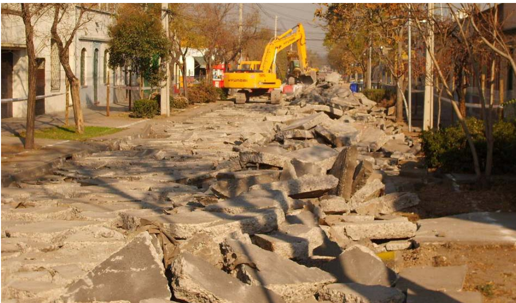
Figura 2.4 Losa de concreto fracturada en un pavimento sin acero de refuerzo, (ACPA).
