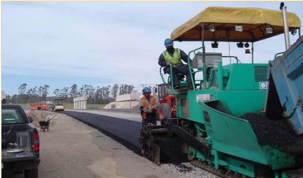
Figura 2.18 Colocación de mezcla asfáltica en caliente sobre el concreto triturado y compactado (RMI, Inc.)
