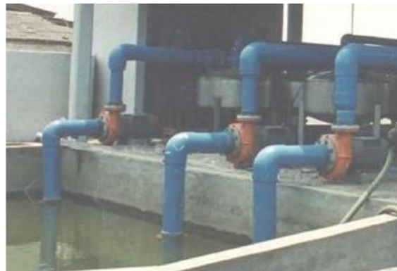
Fig. 55. Tubería de succión sin entrada de aire
