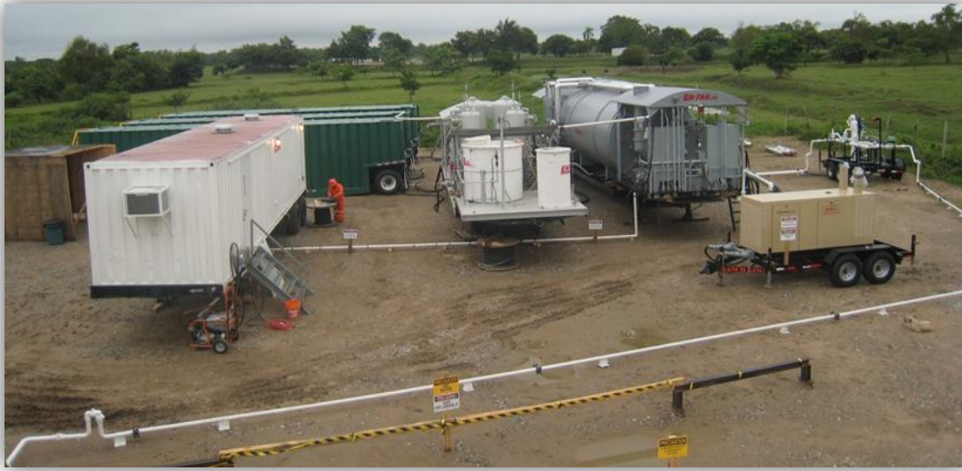
Fig. 23 Generador de vapor en campo Samaria
