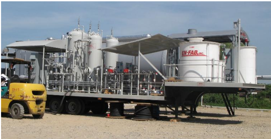
Fig. 62 Generador de vapor utilizado en campo Samaria.
