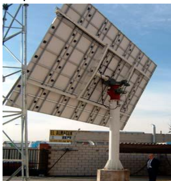
Figura 2: Seguidor solar de dos ejes
