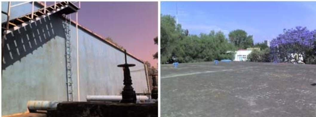
Figura 3.10 y 3.11 Tanque Alto
