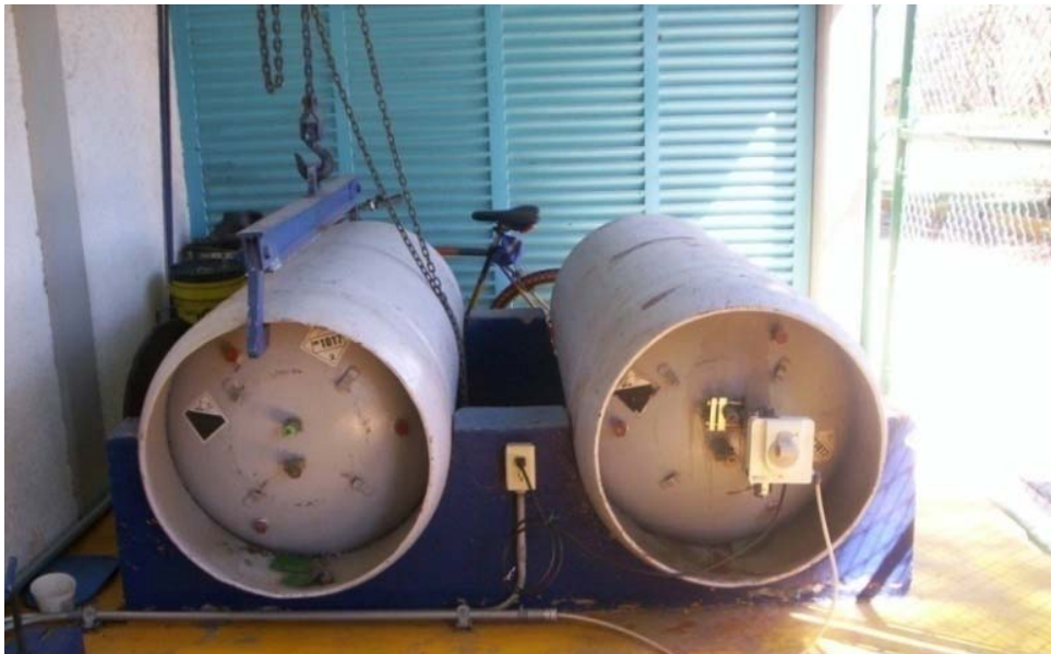
Figura 3.18 Tanques de gas cloro usados en la desinfección del agua del pozo 3
