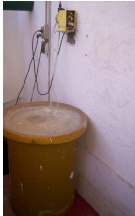
Figura 3.8 Tanque de Hipoclorito de Sodio
