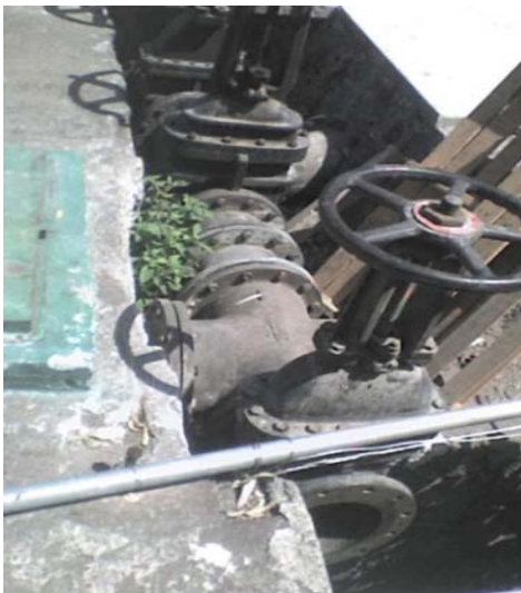
Figura 3.4 Válvulas del Tanque bajo
