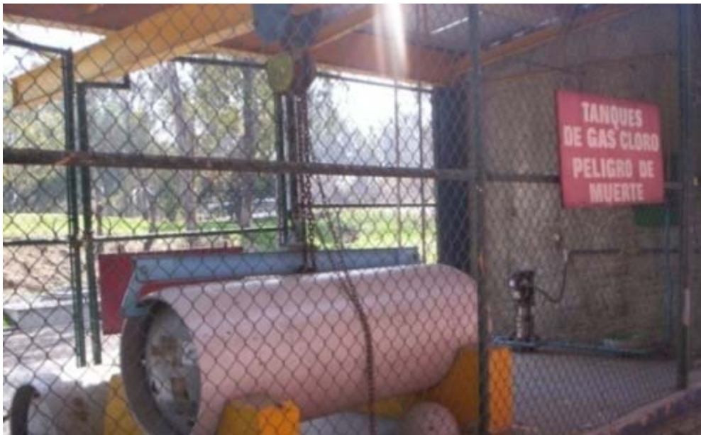
Figura 3.13 Tanques de Gas Cloro de 907 Kg con malla ciclónica de protección.
