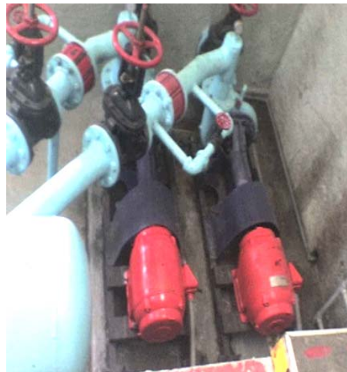
Figura 3.5 Bombas del Tanque bajo
