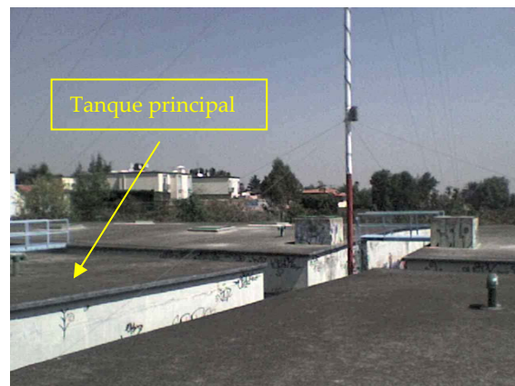
Figura 3.16 Tanques de almacenamiento
