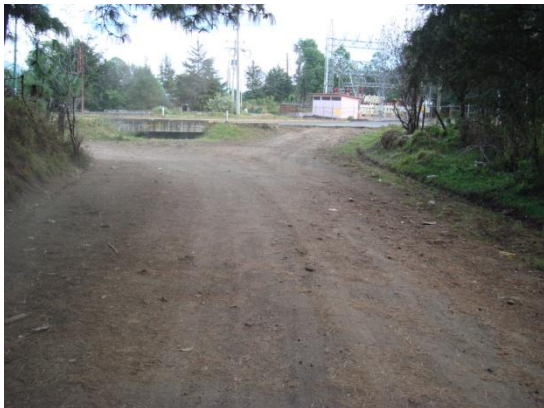
Fotografía. 3.1. Estado actual del camino.
