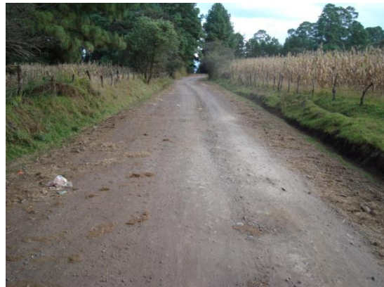
Fotografía. 3.2. Estado actual del camino.
