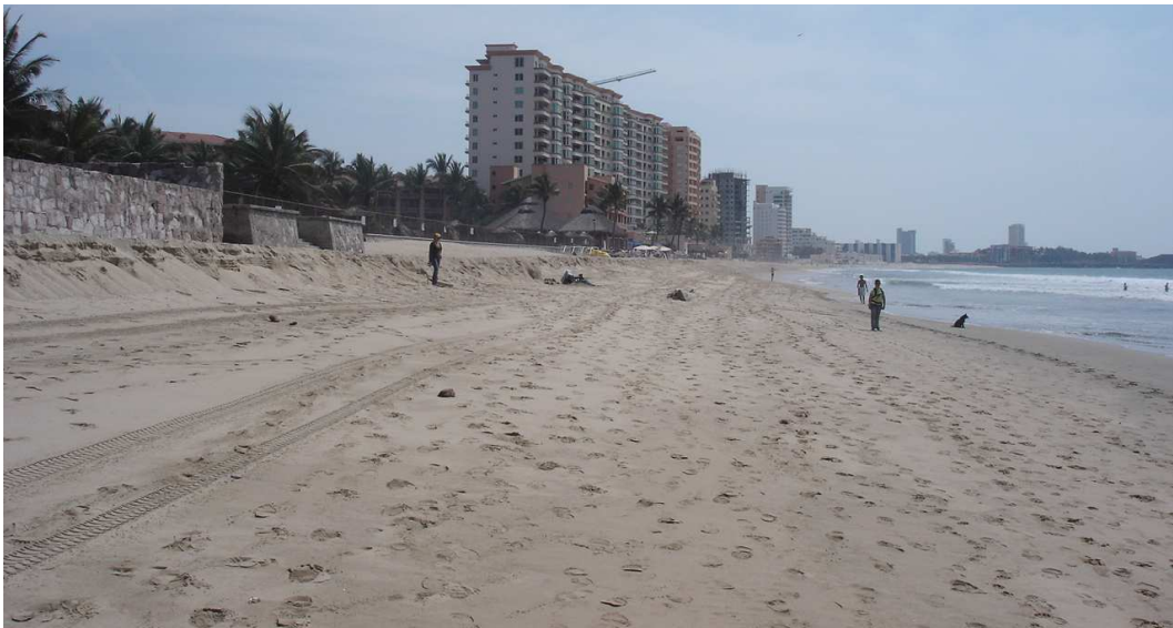
Figura 13. Perfil morfológico de playa "d" (tomada en dirección NW-SE). Obsérvese el escalón erosivo en la playa y su extensión a lo largo de la playa, con dirección SE, determinado por la ruptura del perfil transversal de playa, ocasionada por el muro de contención, al final de la calle López Portillo.
