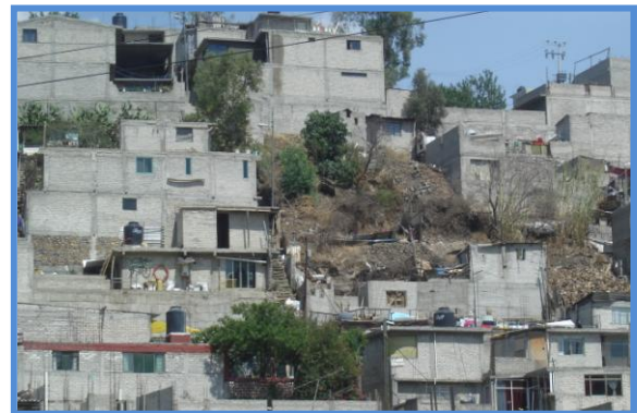
Fig. 56 Problemática de Deslizamientos de Tierra Av. Cantera Alfonso.
