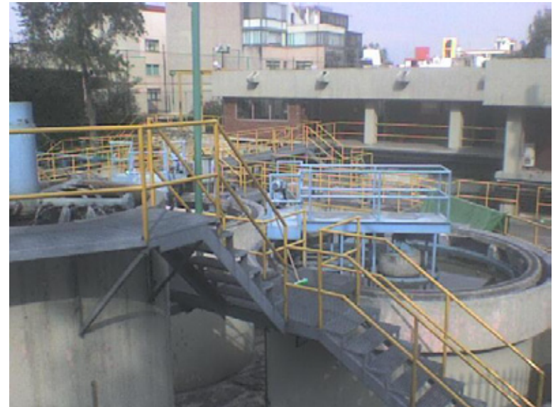
Planta de tratamiento de agua de Ciudad Universitaria
