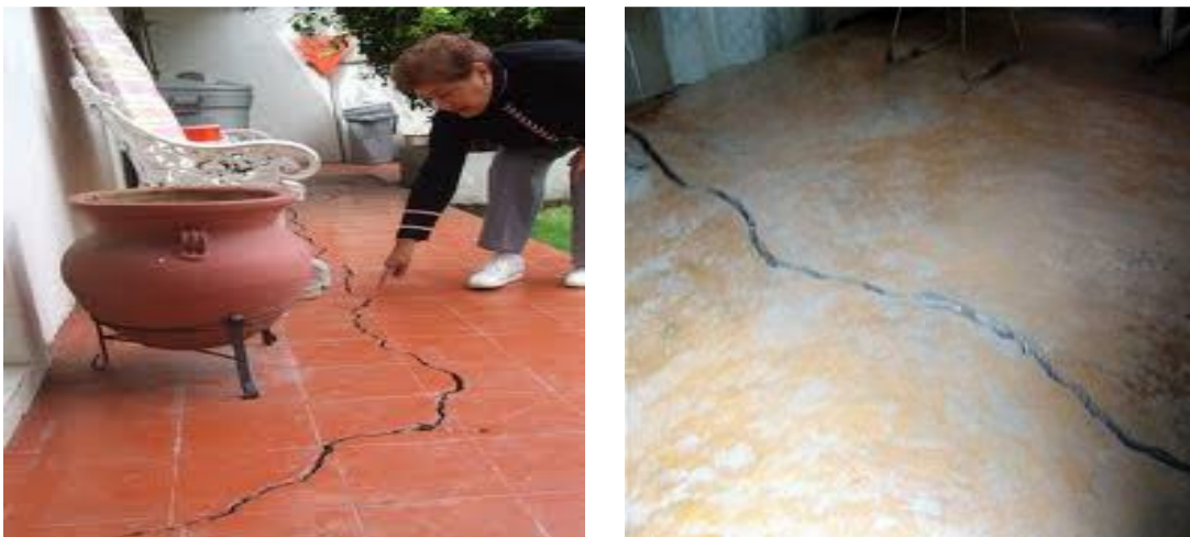
Figura B14. Ejemplo de grieta de pisos
