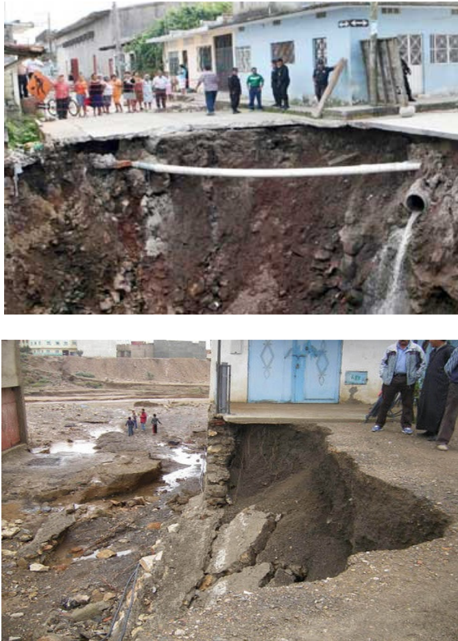
Figura B8. Ejemplo de una vivienda con arrastre alrededor de la cimentación
