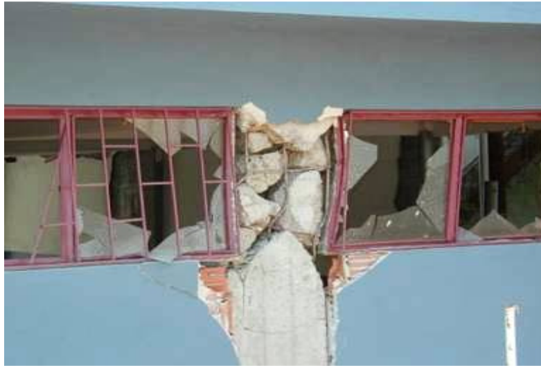
Figura B23. Ejemplo de Fractura de columnas
