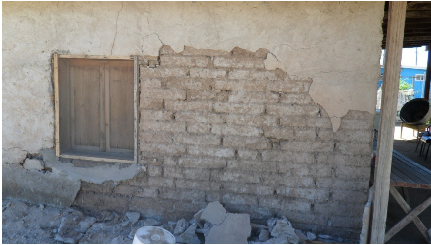
Figura B17. Ejemplo de fisuras y desprendimiento de acabados en muros
