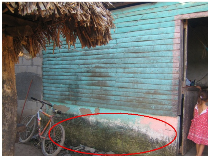
Figura B12. Ejemplo de pequeños daños en pintura de muros
