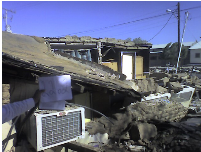
Figura B26. Ejemplo de derrumbe parcial en techumbres de materiales permanentes
