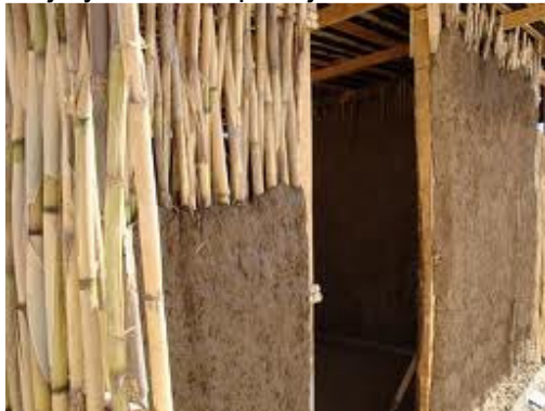
Figura 3.3 Vivienda con carrizo en muros
