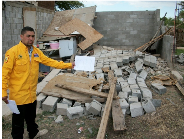
Figura B21. Ejemplo de muros totalmente derrumbados
