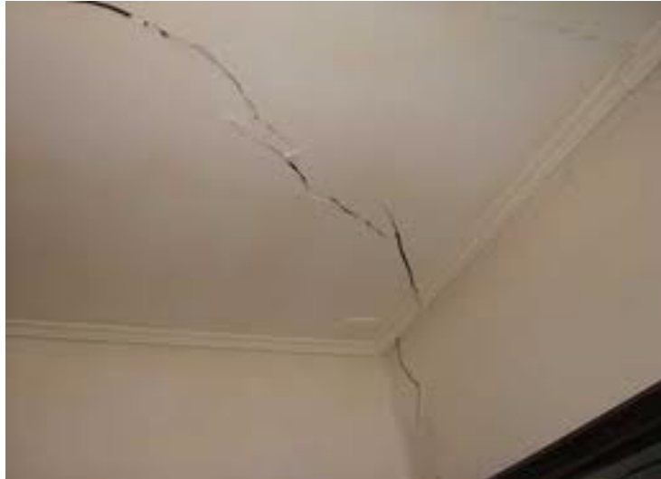
Figura B25. Ejemplo de fractura en techumbres de materiales permanentes
