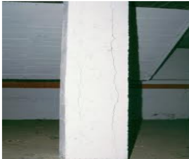
Figura B22. Ejemplo de agrietamientos menores a medio centímetro de espesor en refuerzos estructurales
