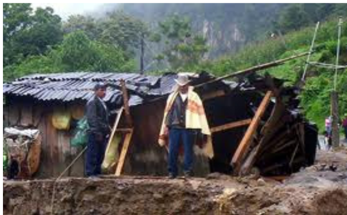
Figura B16. Ejemplo de daños en muros de materiales ligeros o flexibles
