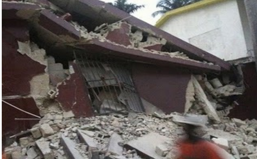
Figura B27. Ejemplo de derrumbe total en techumbres de materiales permanentes
