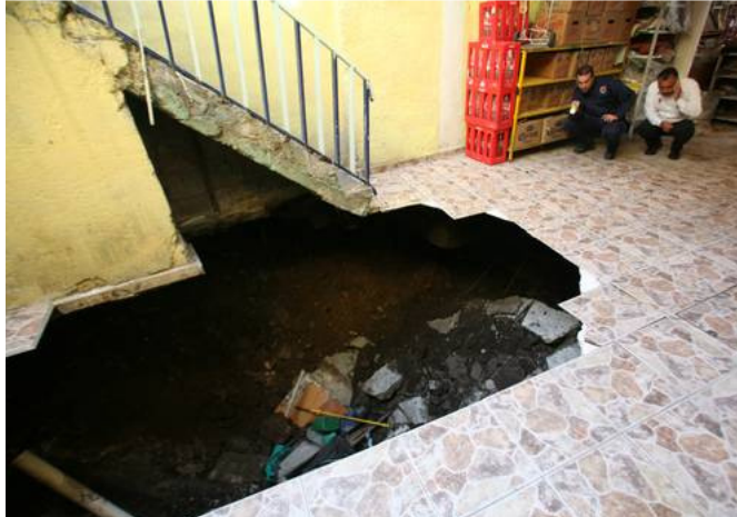
Figura B15. Ejemplo de hundimiento
