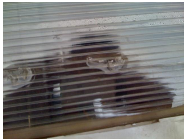
FIGURA 3.19. Deformaciones en el colector "A"
