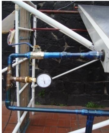
FIGURA 3.11. Termómetros y manómetros de entrada y salida
