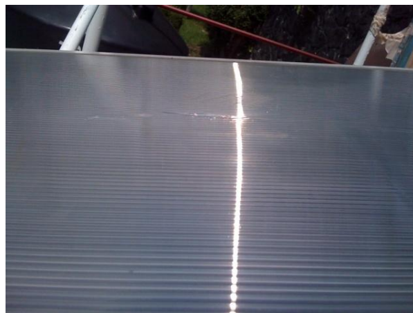
FIGURA 3.18. Deformaciones en el colector "A"
