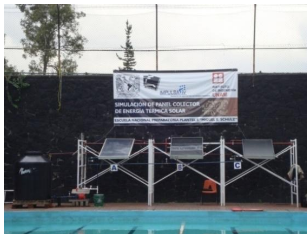
FIGURA 3.2. Vista de conjunto de 3 colectores
