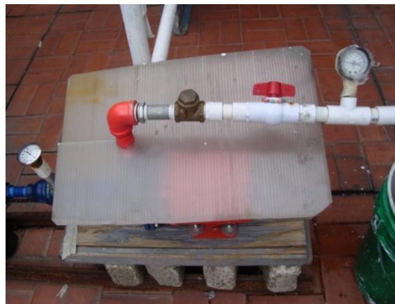
FIGURA 3.10. Termómetros y manómetros de entrada y salida
