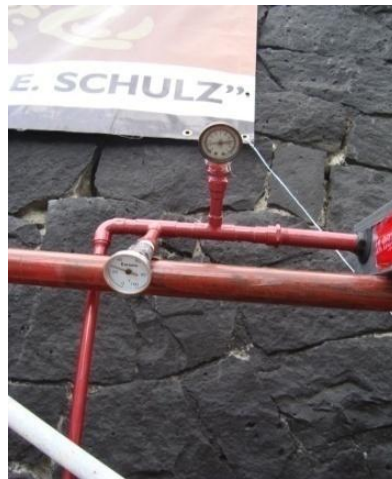
FIGURA 3.12. Termómetros y manómetros de entrada y salida
