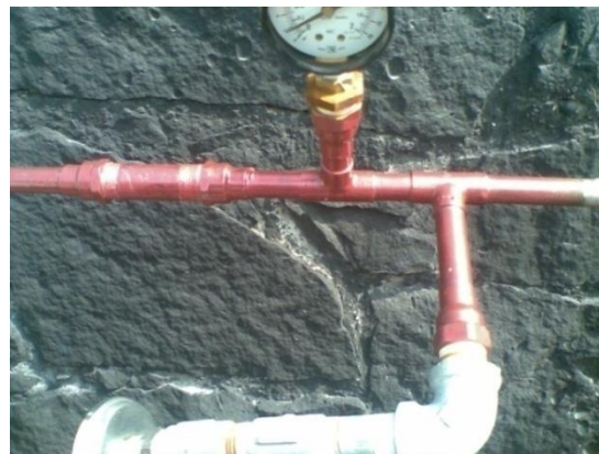
FIGURA 3.15. Colector Solar A.
