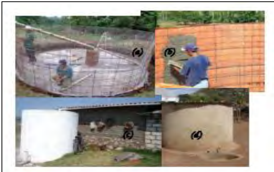
Figura 4.8 (a) Colocación de malla electro soldada (b) aplanado con mezcla de arena y cemento (c) tubería de PVC cortada a la mitad para conducir el agua de lluvia a la cisterna y (d) cisterna con tapa de lámina corrugada. (D. Phillips y col., 2006)
