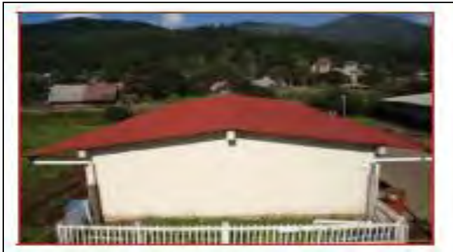
Figura 4.2 Techos de escuelas utilizados como áreas de captación del agua de lluvia. (D. Phillips y col., 2006)
