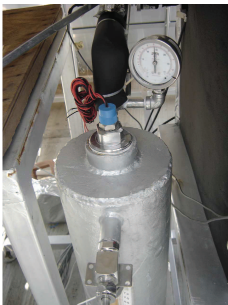
Fig. 2.7. Instalación final del nivel de solución de amoníaco con salida digital para control de la válvula solenoide.
