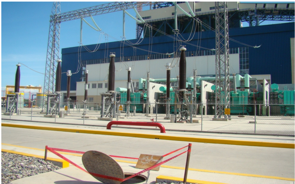
Imagen 3.8. Toma del enlace subterráneo entre el transformador principal del generador No.7 y la subestación LCP.
