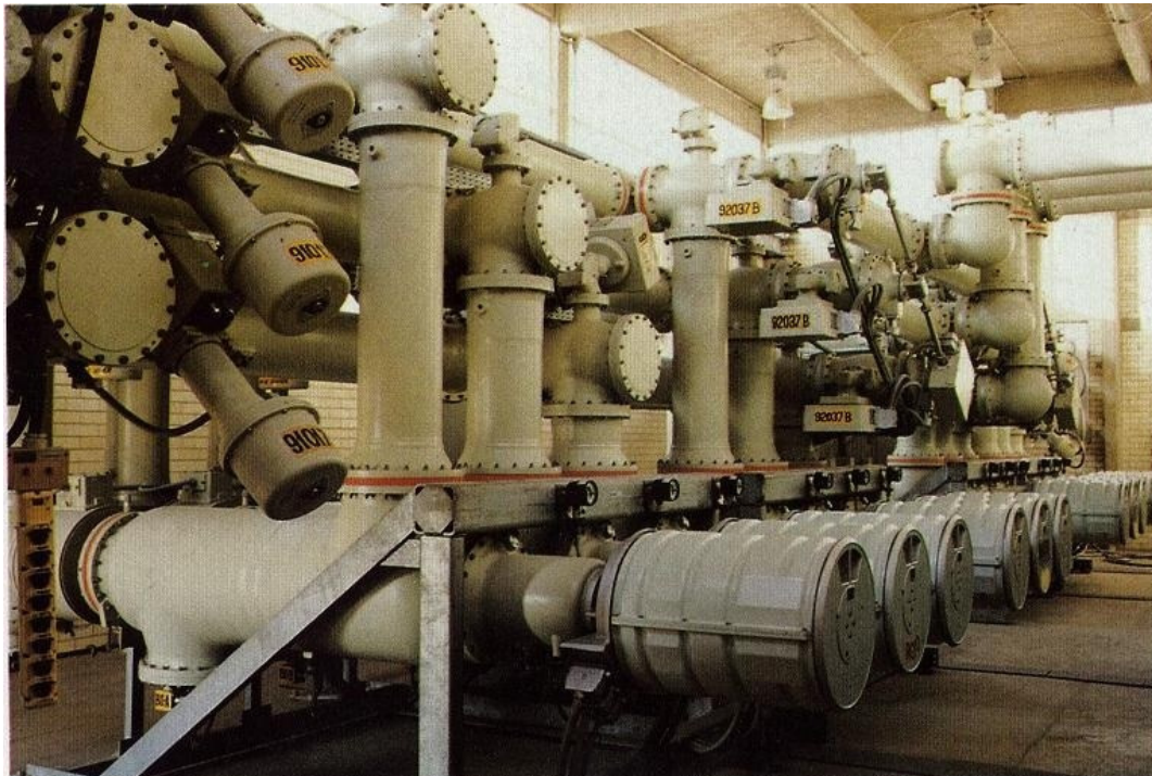
Imagen 3.6. Subestación encapsulada en SF6
