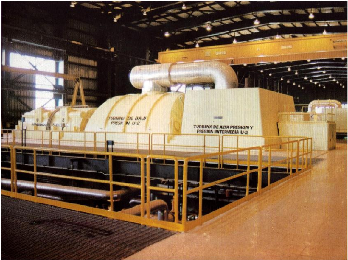
Imagen 3.2. Turbina de baja, de alta y de presión intermedia de la Unidad de Generación No.2 de la Central de Petacalco
