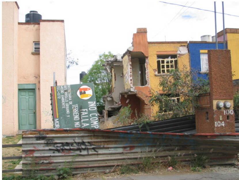
Figura 5.3- Daños en casas habitación, debido a hundimientos asociados con la falla “La Colina” y la excesiva extracción de agua del subsuelo. Colonia Tres Puentes, Morelia (Arciniega, 2008).
