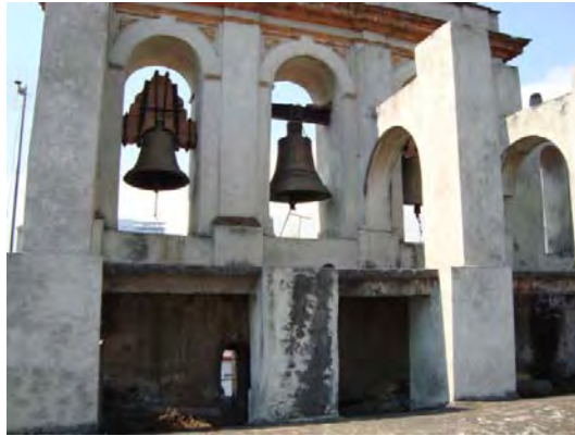
El Carmen 15 basa de espadaña donde se puede apreciar claramente la terrible losa de concreto de 20cm, que solo suma un innecesario peso extra a la bóveda de cañón de la nave.
