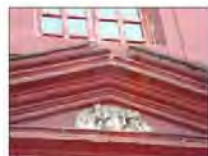
CORONA DE FRONTO FABRICADA EN TABIQUE QUE PRESENTA PERDIDA DE EL REVESTIDO PERDIDA DE CAPA PICTORIAL Y DESPRENDIMIENTO DE APLANADO.
