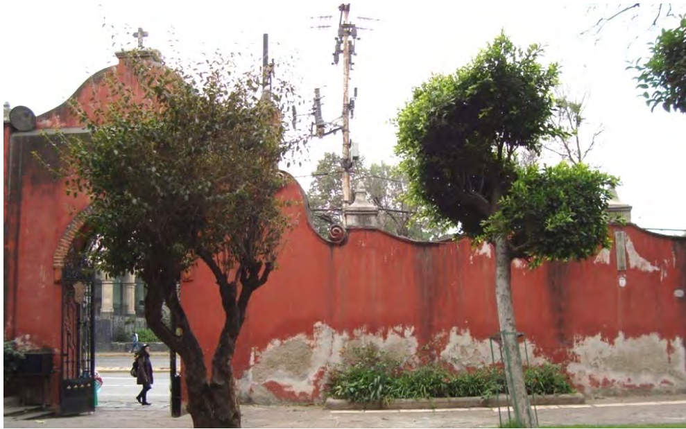
El Carmen 10 deterioro de humedades ascendentes y descendentes, así como pérdida de recubrimiento.
