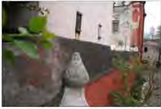
SUPERFICIE DE CHAFLAN QUE PRESENTA MANCHAS DE ESCURRIMIENTOS PLUVIALES OCASIONADAS POR ALGAS Y MICROFLORAS. CEJA DE LADRILLO CON PERDIDA DE PIEZAS Y JUNTEO QUE OCASIONA TALES FILTRACIONES
