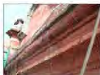
APLANADO DEL REMATE MOTIVO QUE PRESENTA PERDIDA DE COLORACION Y DESPRENDIMIENTO DEL ARJ ANCHO.
