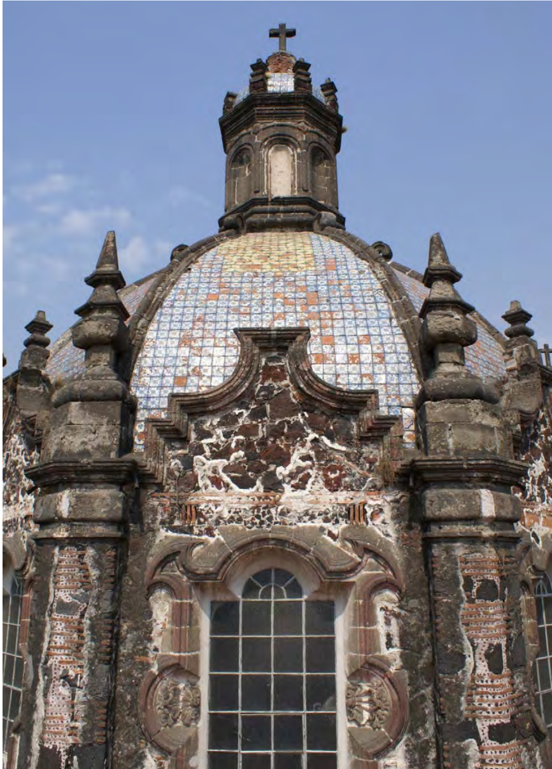
El Carmen 35 detalle de la cúpula principal, se puede apreciar el desgaste de la azulejería y su disconforme reposición.
