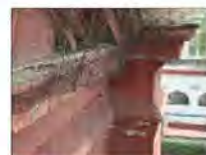
FLORA PARASITA Y EXISTENCIA DE GUSANO DE PALOMA UBICADO EN EL REMATE DE LAS FILASTRAS DE LA FACADA.
