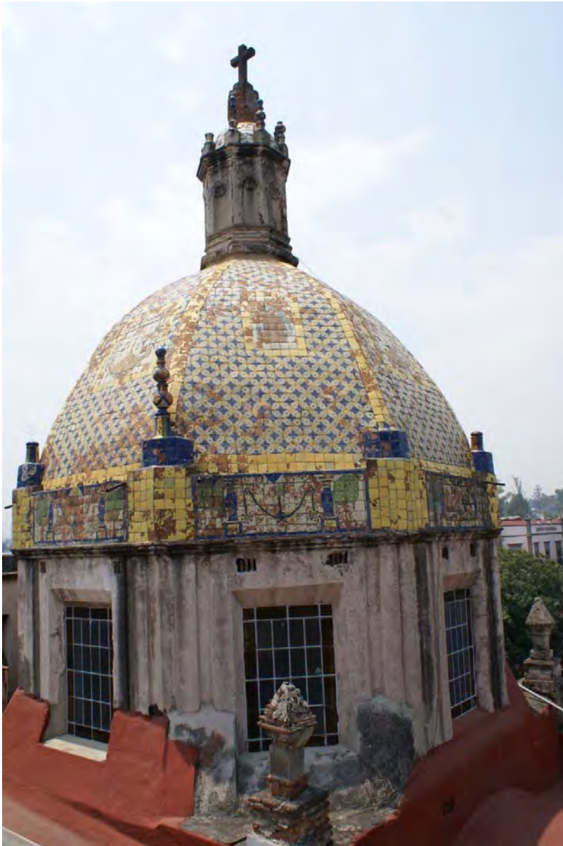
El Carmen 54 deterioros múltiples, como pérdida de elementos, desintegración, intervenciones fallidas, humedad, entre otros en cúpula capilla de indios
