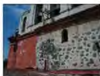
CEJA Y REMATE DE TABIQUE DETERIORADO POR HUMEDAD E INTERVENCIONES ANTERIORES. PRESENTA PERDIDA DE PIEZAS Y JUNTEO DE MEZCLA.
