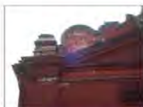
REMATE DE FILASTRA QUE PRESENTA DISHOMOGENEA Y PERDIDA EN SU HORIZONACION FABRICADA DE TABIQUE Y APLANADO DE MEZCLA.
