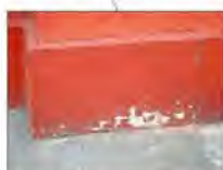
SUPERFICIE DE NICO MOSTRANDO AGRIETAMIENTO Y DESPRENDIMIENTO DE APLANADO OCASIONADO POR HONGOS Y AGRIETAMIENTO.
