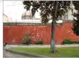
SUPERFICIE DE MURO QUE PRESENTA PERDIDA DE CAPA PICTORICA, CRAQUELAMIENTO GENERALIZADO EN SU APLANADO Y PROLIFERACION DE MICROFLORA DEBIDO A HUMEDADES ASCENDENTES Y A LA PERDIDA DE PENDIENTES ADECUADAS EN CHAFLANES.
