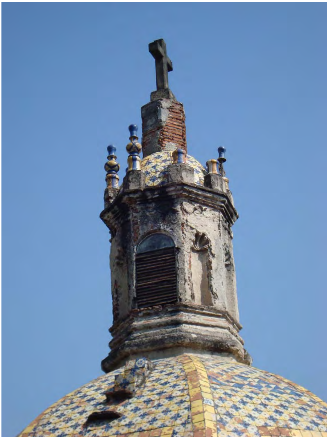
El Carmen 20 linternilla gravemente deterioradora de la Capilla de Indios.
