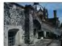
VISTA GENERAL EN LA QUE SE APERCIBIA DISCREPANCIA DE APLANADO EXISTENTE EN MURO, EXISTENCIA DE FLORA Y MICROFLORA PARASITA EN DESALZOS FLUJUALES DE CONTRAFUERTES. CEJA DE TABIQUE DETERIORADA POR HUMEDAD, PERDIDA DE PIEZAS Y DE JUNTEO DE MEZCLA.
