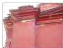
CORONA DE FILASTRAS Y FRONTO FABRICADA EN TABIQUE QUE PRESENTA PERDIDA DE CAPA PICTORIAL Y LEVES DESPRENDIMIENTO DE APLANADO.
