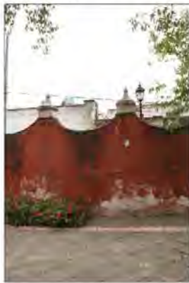
PERDIDA DE CAPA PICTORICA ASI COMO DISGREGAMIENTO DE APLANADO OCASIONADO POR HUMEDADES ASCENDENTES. CRAQUELAMIENTO PARCIAL EN SUPERFICIE RECUBIERTA DE APLANADOS EN BASE A CEMENTO EN CUYOS AGRIETAMIENTOS PROLIFERAN ALGAS Y MICROFLORAS.
