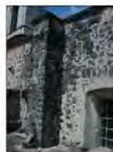
DISCREPANCIA DE APLANADO EXISTENTE
