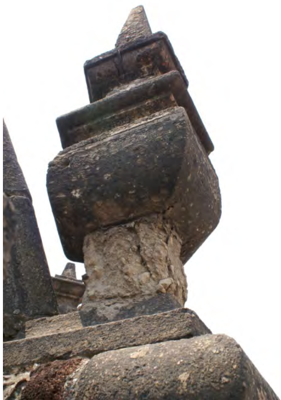
El Carmen 34 este es un magnífico ejemplo de lo que el intemperismo y los ácidos ambientales han causado a los pináculos de la cúpula principal al grado de pulverizar el material pétreo.
