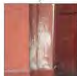
SUPERFICIE DE FILASTRA MOSTRANDO AGRIETAMIENTO Y DESPRENDIMIENTO DE APLANADO OCASIONADO POR HONGOS Y AGRIETAMIENTO.
