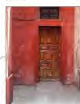
SUPERFICIE DE FACADA QUE PRESENTA ZONAS CON RESERVAS ANTIGUAS A LA BASE DE MEZCLA CON CEMENTO MOSTRANDO AGRIETAMIENTO LEVES (AUNQUE LA MEZCLA PARECE). ASI COMO PERDIDA DE CAPA PICTORIAL Y APLANADO.
