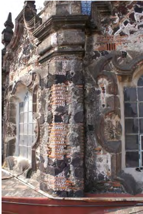
El Carmen 31 deterioro de intervención anterior en pilastra izquierda vista poniente cúpula principal.
