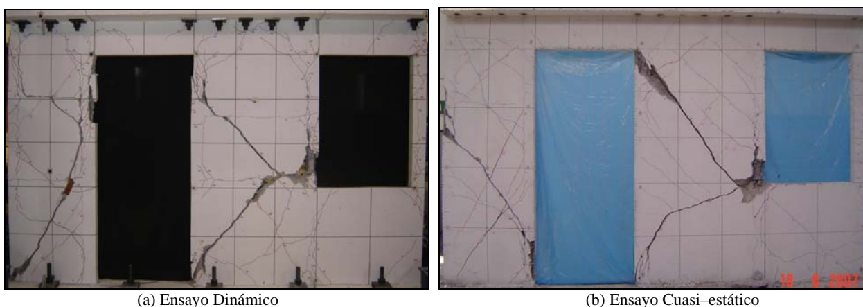
Figura 5-74. Estado final del daño en el modelo MVN50m
