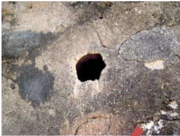
Deterioro debido al ataque animal, que construyen sus nichos y madrigueras en las estructuras, causando perforaciones que van desde 2 mm hasta 8 cms. aproximadamente. Foto: Pérez, M. Ruina No. 5
