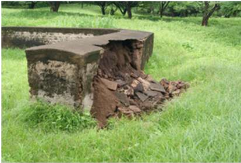
Colapso de los muros originales de la estructura No.4 durante el invierno del 2010. Foto. Archivo El Nuevo Diario, Nicaragua.
