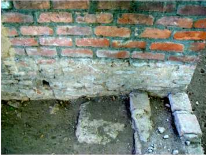
Deterioro por agua del subsuelo y sales solubles que se agrava al agregarse zócalos y rellenos impermeables. Foto: Pérez, M. Ruina No.1; Gráfico: Viñuales, G.
