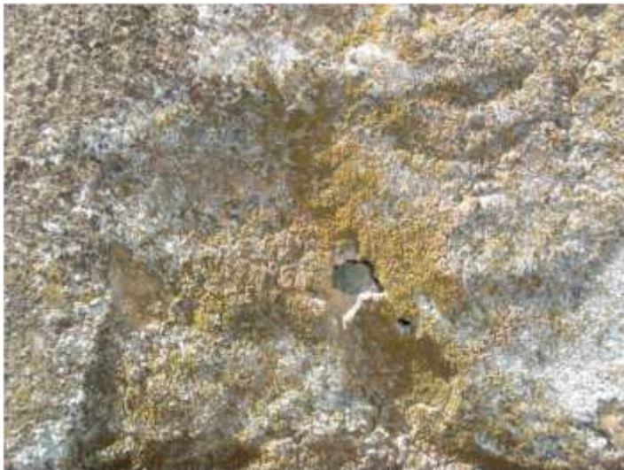
Manifestación de sales solubles: eflorescencias y subeflorescencias en las fábricas de las Ruina No.1
