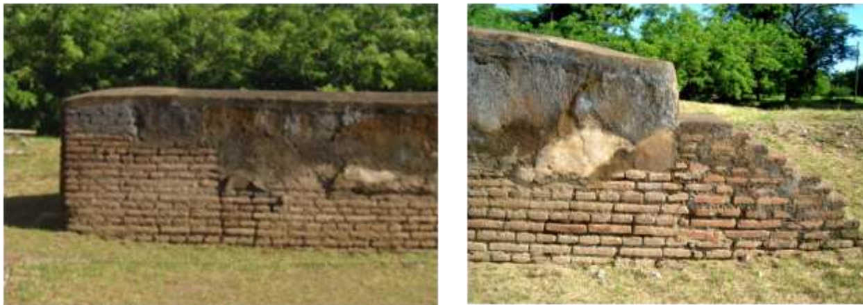
Deterioros por sismicidad: agrietamientos y asentamientos. Ruina No.1 Catedral Santa Ma. De la Gracia.
