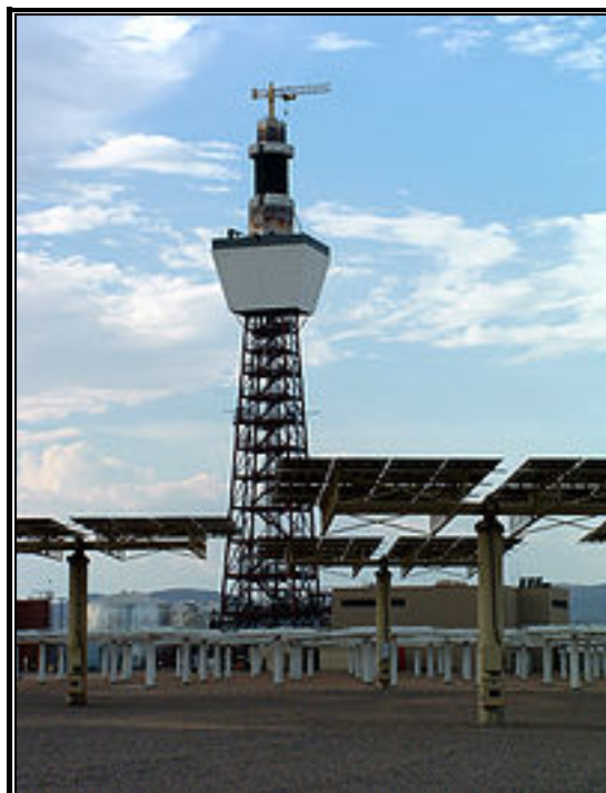
Torre central solar. FIGURA 2.10
