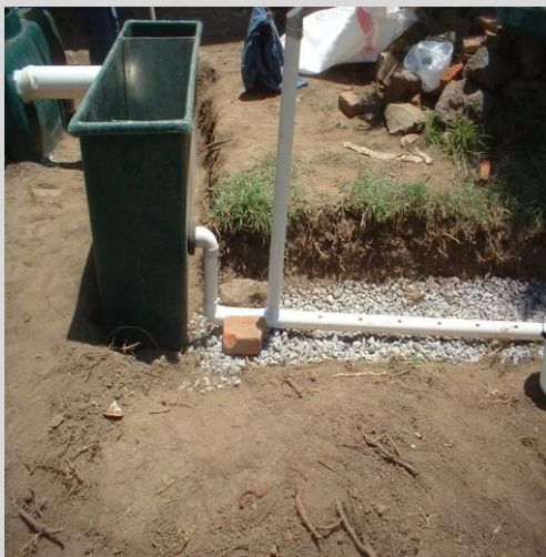
Clarificador y Sirdo domestico colocado
