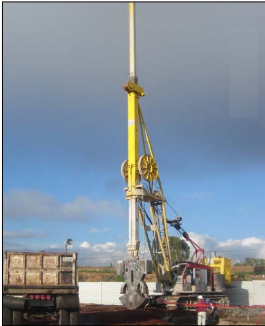
Figura 3.3.- Equipo guiado y centralina
