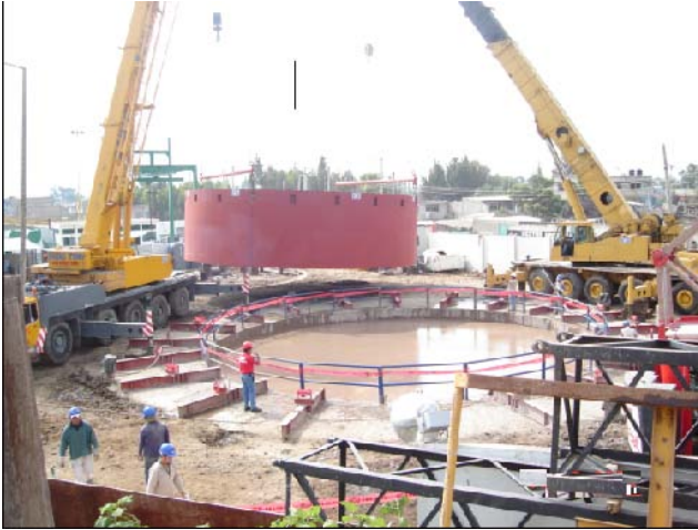
Figura 4.25 Maniobra realizada para la colocación de tanque metálico con ayuda de grúas
