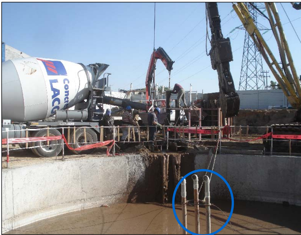
Figura 4.33 Tubería empleada en la inyección de mortero al fondo de la lumbrera
