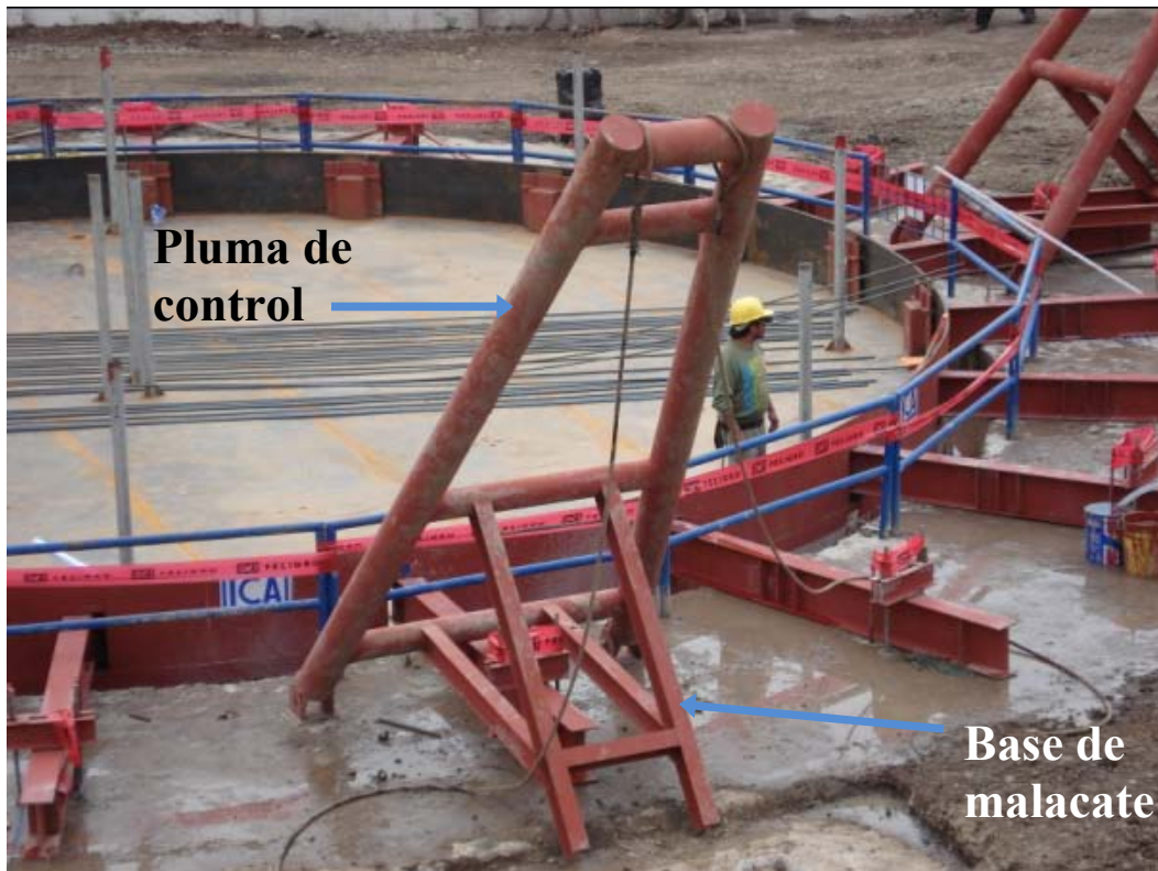
Figura 4.28 Plumitas de control perimetrales
