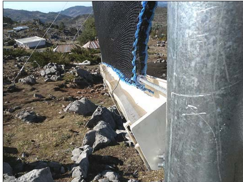
Figura 119.Canaletas de conducción de agua pluvial.
