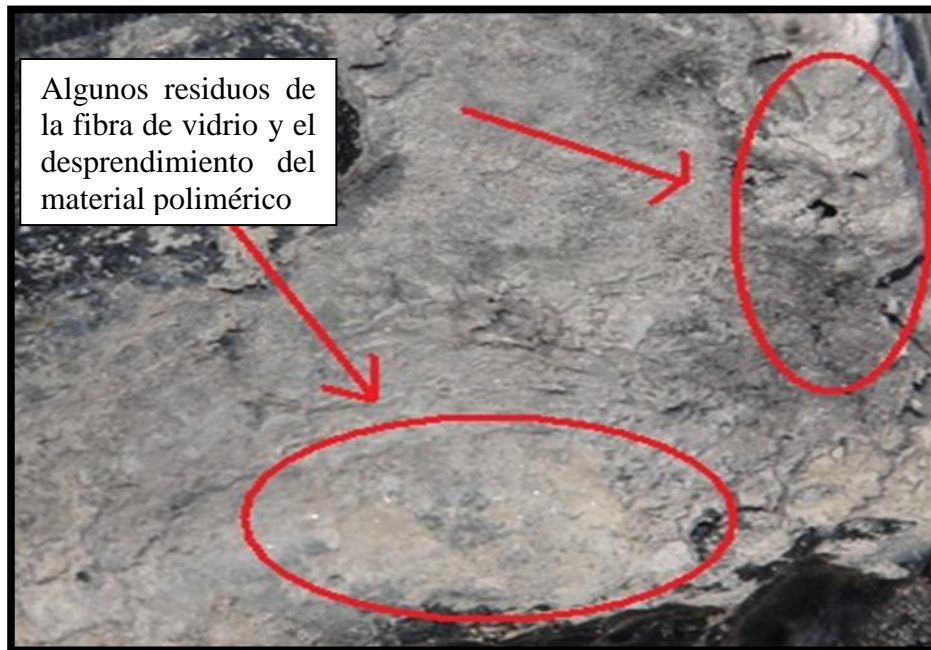
Figura 3.18 En esta imagen se observa pérdida de textura.
